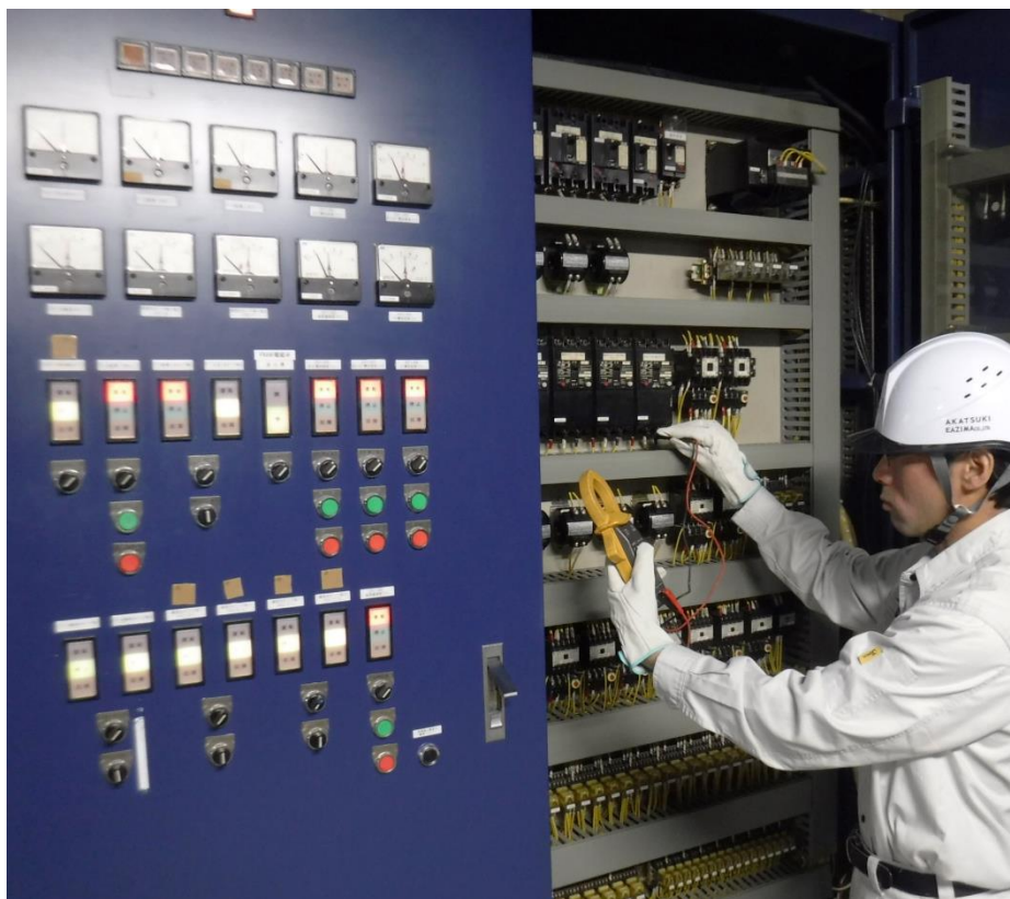
空調機制御盤点検
