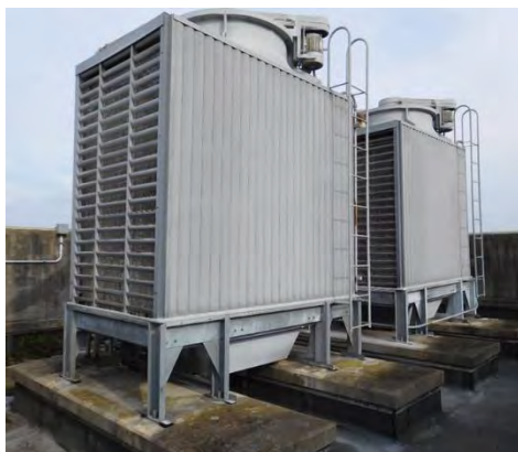
油焚冷温水発生機 冷却塔
