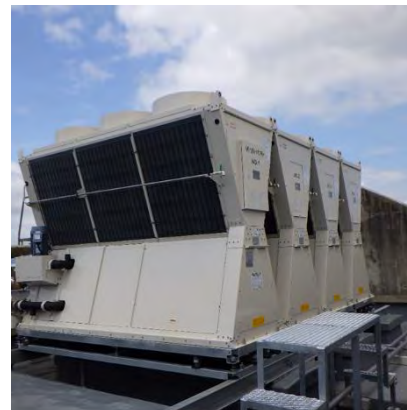
空冷チラーユニット
